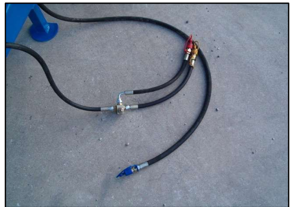
Abb. 2.5 - Hydraulische Verrohrung und Farbgebung der Schnelltrennkupplungen
